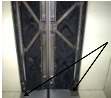
圖十一 車間通道異常傾斜
