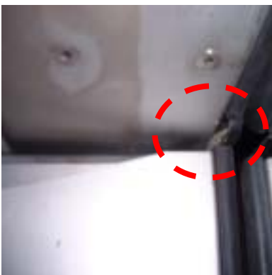
圖十三 天花板變形損壞裂
