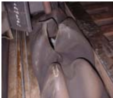
圖十 車間通道橡膠護罩破裂
